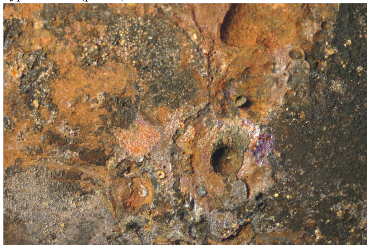
Рис. 1. Внешний вид язвы с продуктами коррозии на внутренней стенке трубы
